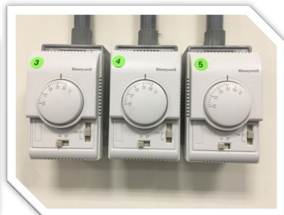
空調採用恆溫裝置
